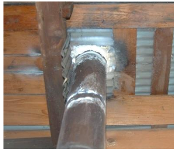
「煙突貫通部からの出火」 木材内部の蓄熱により低温発火
