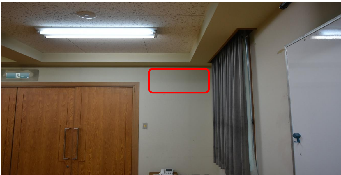
○室内機設置場所
