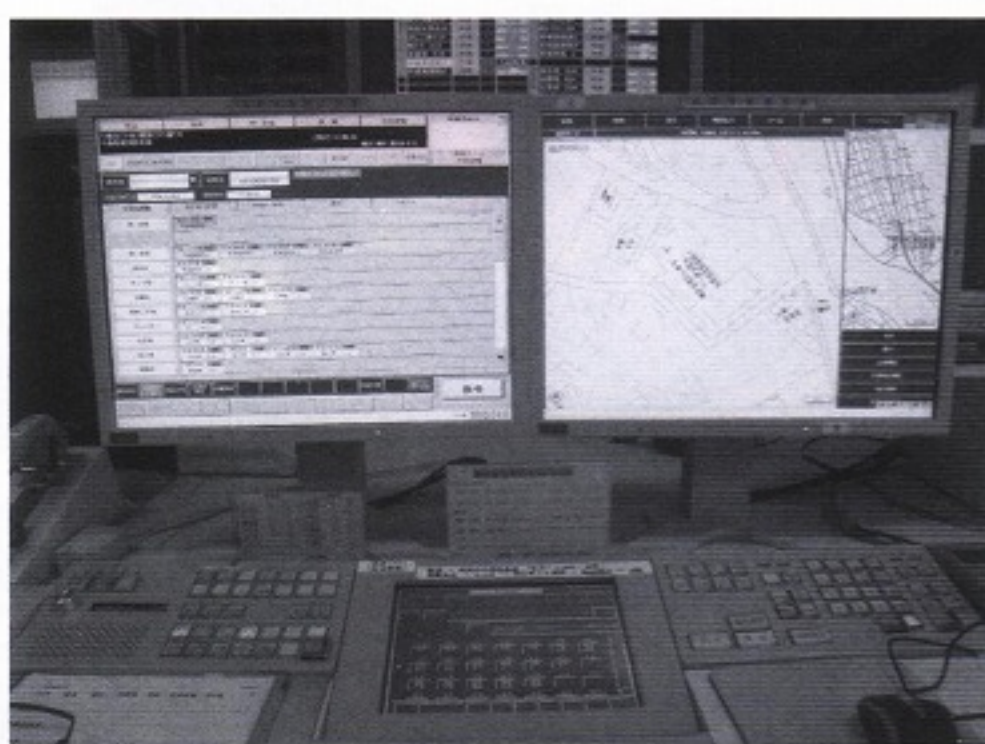
消防緊急通信指令システム
