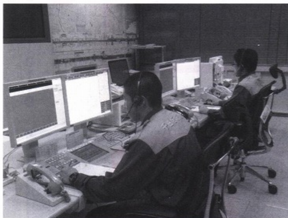
消防通信指令室の様子
